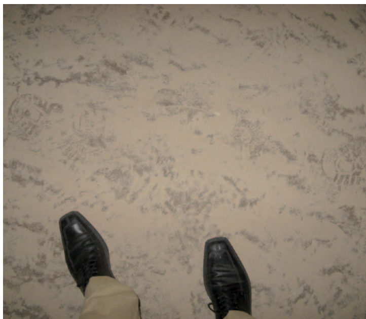
Gangvloer bij een overslagbedrijf van Agribulk. De aanwezigheid van zichtbare voetafdrukken in het stof kunnen aanleiding zijn voor gevarensone-indeling vanwege stofexplosiegevaar.
