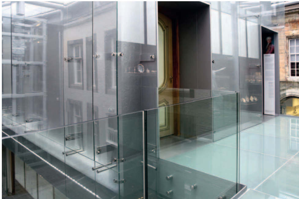
Eenzijdig ingeklemde balustrade in Museum aan het Vrijthof in Maastricht. Foto: Glass Inside
