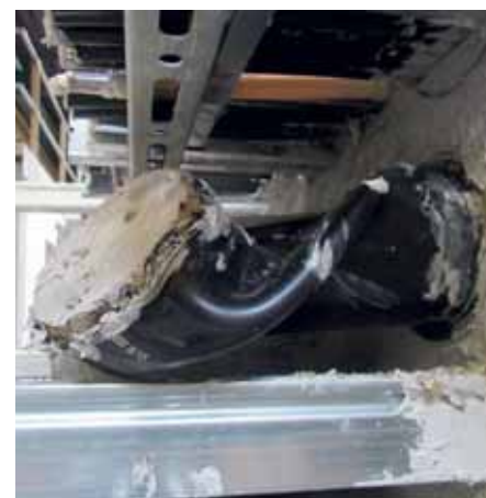
Vervormde PE-buis na een rookdoorlatendheidsproef volgen NEN 6075.
