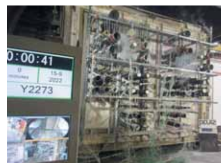
Schachtwand tijdens een brandtest (aanzicht niet-verhitte zijde) (Preficon Europe).
