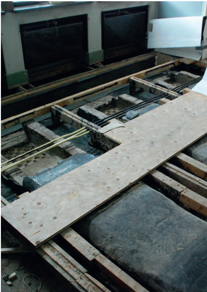
Leidingen in de verdiepingvloeren, met zicht op de gemetselde plafonds. Leidingdoorvoeren zijn brandwerend gemaakt.
