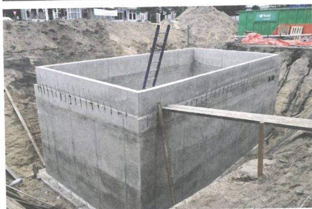
Buiten het gebouw is een ondergrondse kelder voor de voor de gebouwinstallatie aangebracht.
