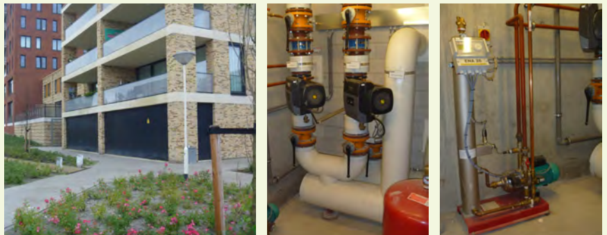
-Foto 2- Centrale WKO-ruimte onder appartementen (links), cv-pompen (m) en de ontgasserinstallatie
