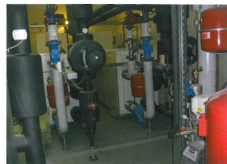
Centrale technische ruimte/warmtepompen
