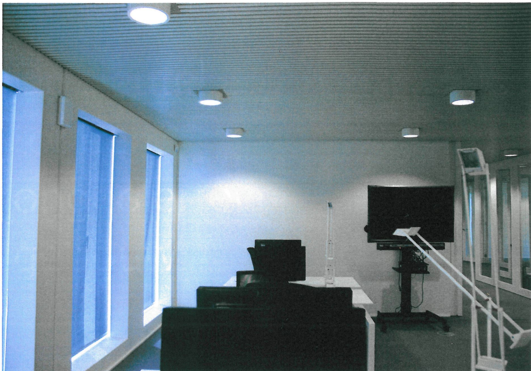
■ Praktijkvoorbeeld van metalen lamellen aan het plafond.
