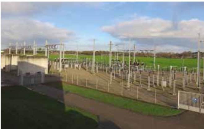
FIGUUR 4: EEN SCHAKELVELD MET LIJNVELDEN EN VERMOGENSSCHAKELAARS
