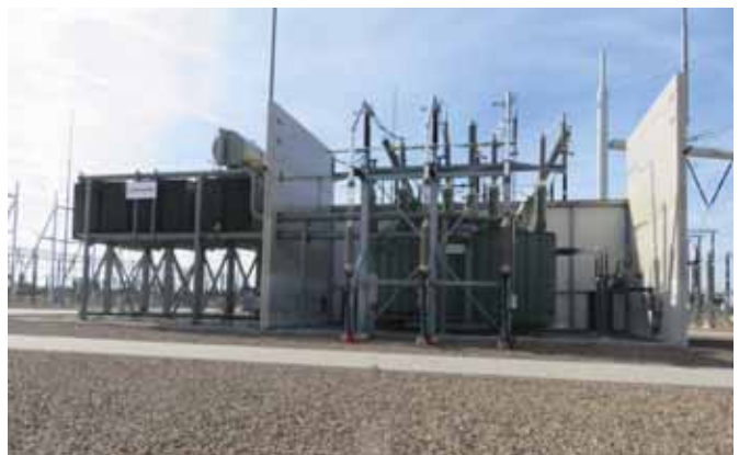
FIGUUR 2: EEN TYPISCHE TRANSFORMATOROPSTELLING TUSSEN SCHERFMUREN MET KOELERS BUITEN DE SCHERFMUREN
