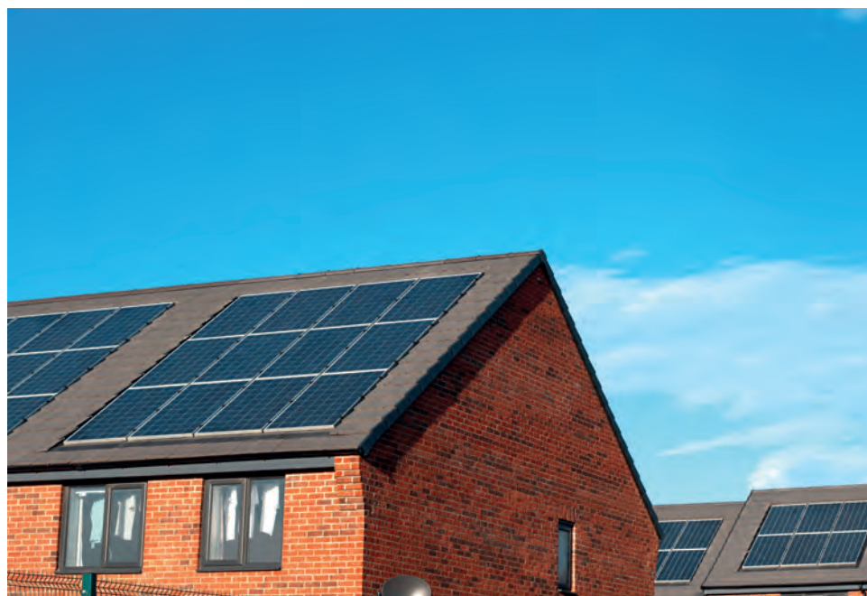
Bij zonnepanelen die in het dak geïntegreerd zijn kunnen vervuiling, takken en vogelnesten zorgen voor een grotere kans op brand.
