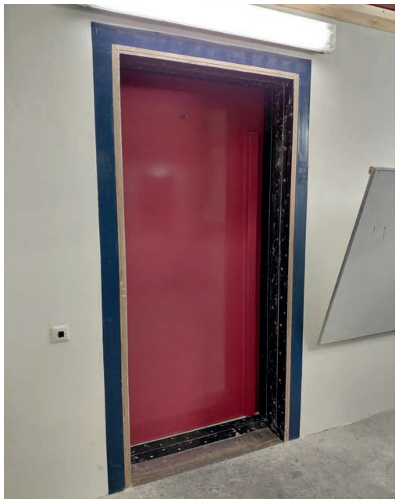
De speciaal daarvoor gerealiseerde meetopening voor deuren.
